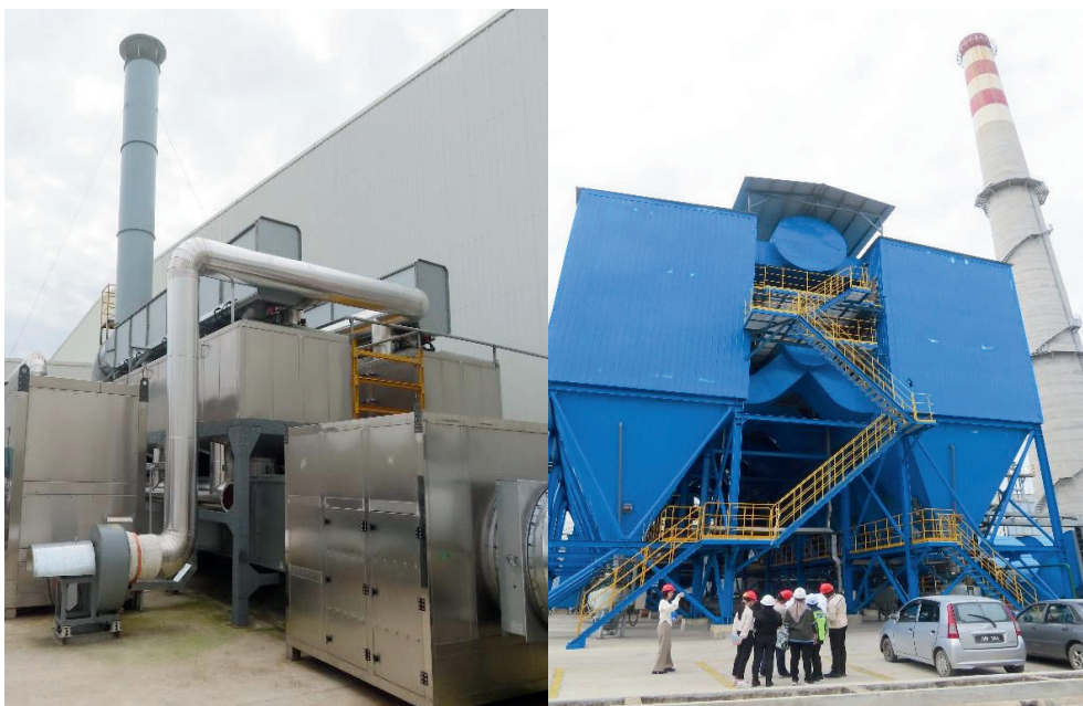
Gambar 8.2: Lawatan Verifikasi Pemasangan Sistem Kawalan Pencemaran Udara (SKPU).
