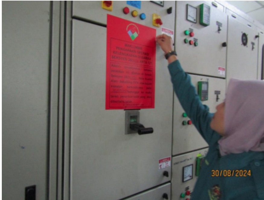
Rajah 34 Penahanan Operasi Kelengkapan (POK) ke atas premis
