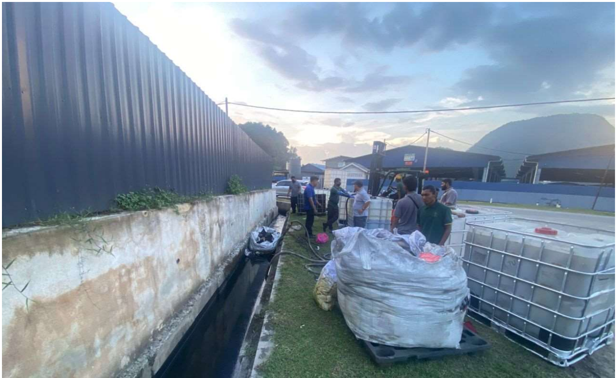
Gambar 4 & 5: Operasi pembersihan dan kawalan tumpahan minyak di dalam longkang luar premis oleh pihak kontraktor
