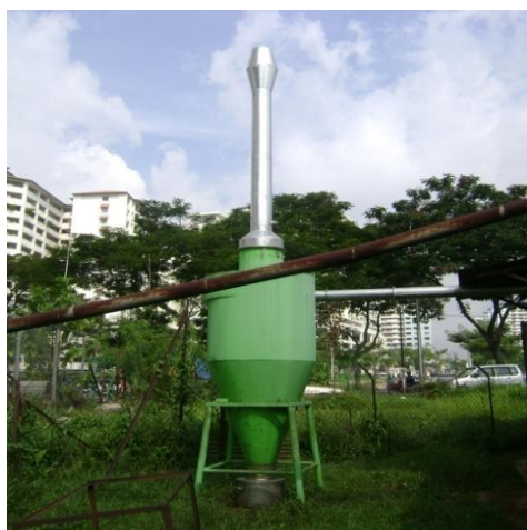
Cyclone Separator - Sejenis Alat Kawalan Pencemaran Udara yang digunakan di dalam industry untuk mengawal pencemaran udara yang dibebaskan.
